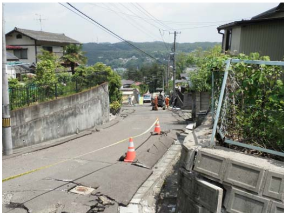
●道路・家屋の被害(仙台市障害者福祉協会提供)
